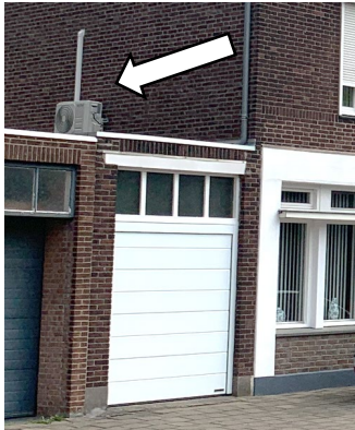
Foto van een buitenunit bevestigd aan een woning
